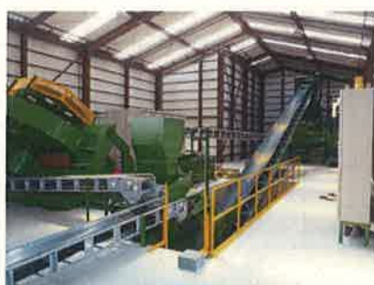
木質バイオマス燃料チップ製造施設
