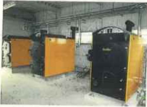
木質バイオマスボイラー
