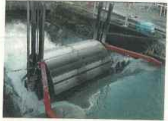
小水力発電施設
