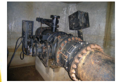
老朽化した施設（築37年）
