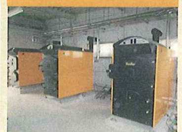
木質バイオマスボイラー
