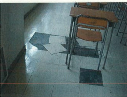
教室内部の床の剥がれ
