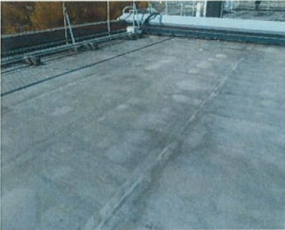
校舎屋上の防水シートの浮き
