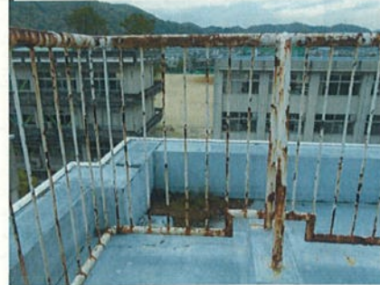
屋上手すり鉄部の錆
