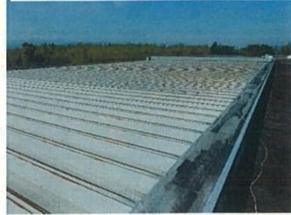
体育館折板屋根の錆
