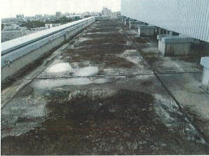
屋上防水保護コンクリートの劣化
