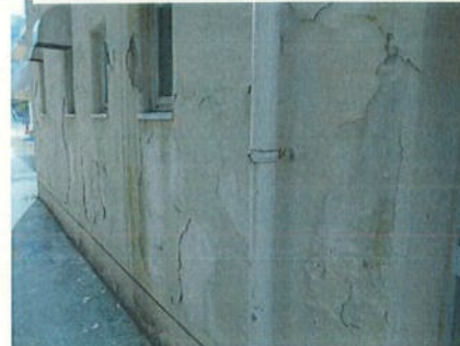
外壁の塗膜の広範囲の浮き
