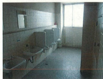
トイレ配管の経年劣化
