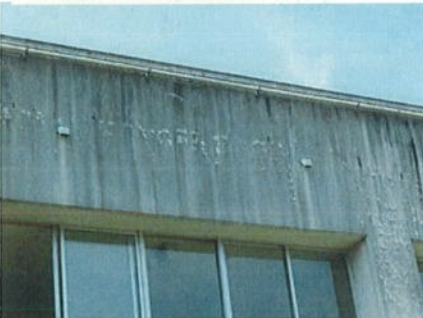
外壁の鉄筋の爆裂
