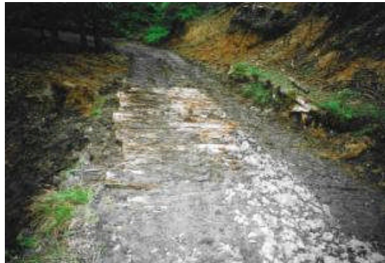
路面工（軟弱な路面）
