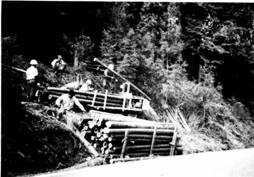
④ 荷卸し土場 道路ぎわでトラ ック積込の容易 なところを選定
