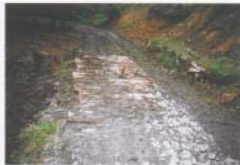
路面工 (軟弱な路面)
