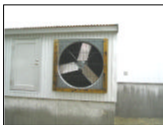
写真 1 換気扇の外観
