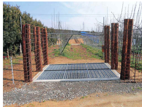
図2 設置状況(奥が果樹園,手前が町道)
