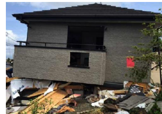
平成28年熊本地震全壊の例
