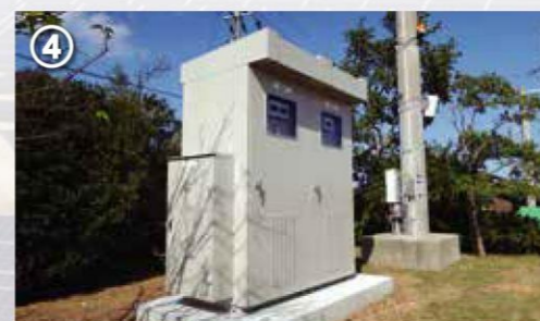
④ 災害時にメガソーラーから電力を取り出せる災害対応分電盤
