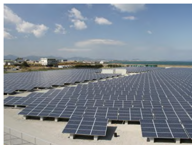
マリンピア沖洲太陽光発電所
