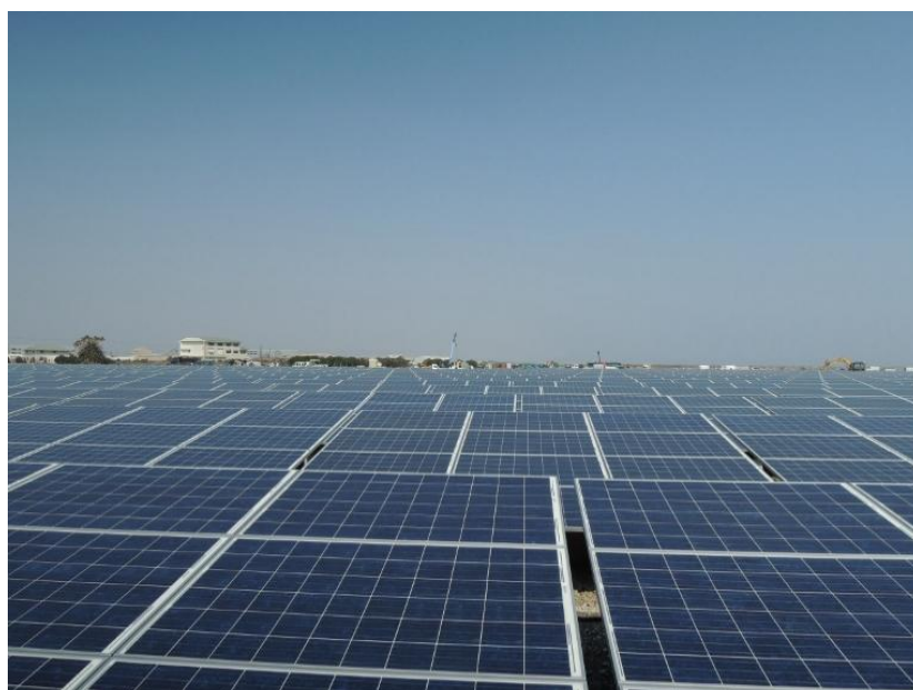
マリンプア沖洲太陽光発電所
