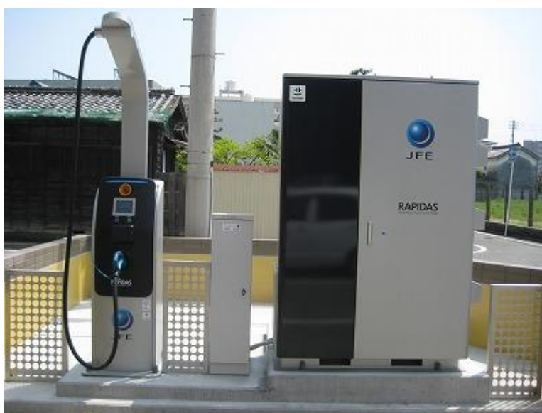
徳島保健所庁舎災害時電気自動車充電設備
