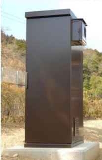
・リチウムイオン電池蓄電システム
