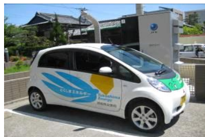
EV急速充電器 (徳島保健所)
