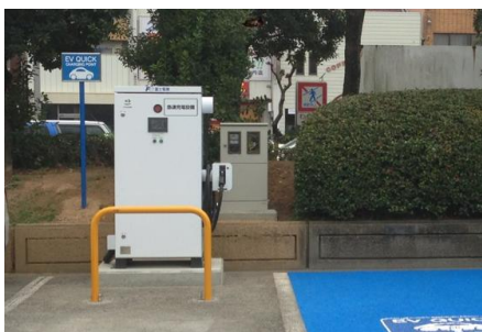
(県庁：EV充電スタンド)
