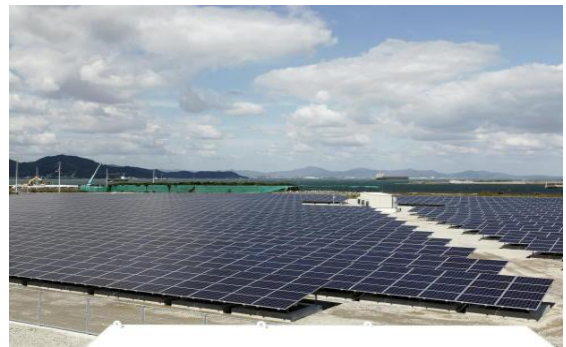
（和田島太陽光発電所）
