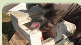
給水栓の凍結防止対策
