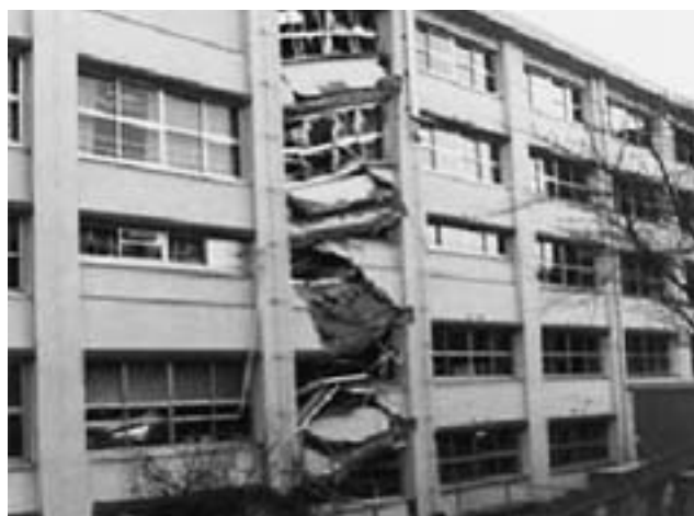
(地震による被害状況)
