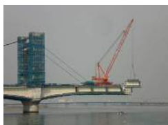
1 段目仮ケーブル
