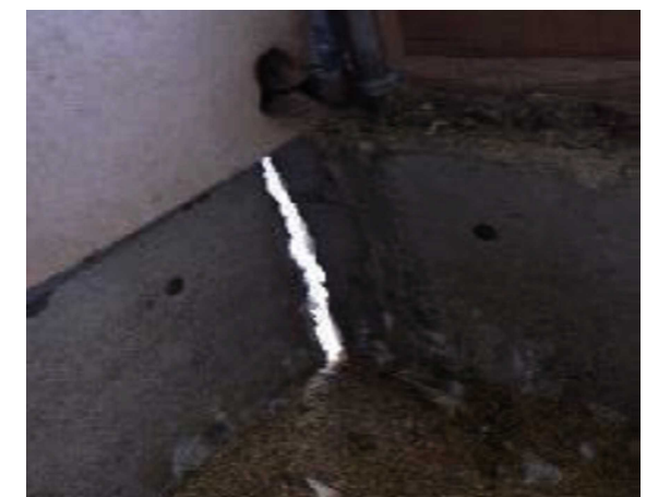
基礎部分にヒビ割れがある。
