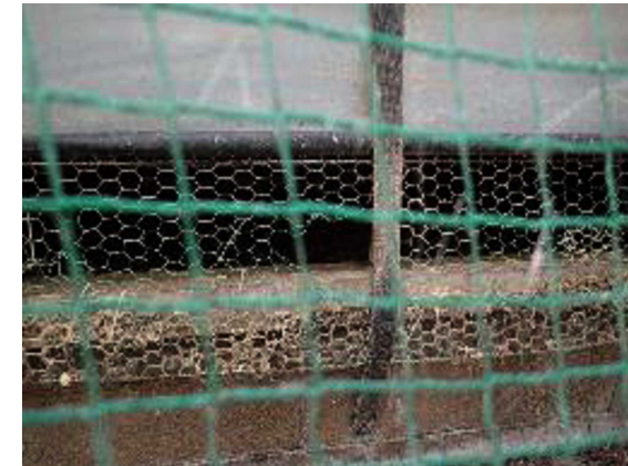
鶏舎側面の金網の破損
