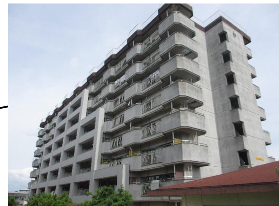
県営住宅金沢団地6・7号棟耐震改修工事 6号棟 RC造8階建て 64戸 7号棟 RC造8階建て 80戸
