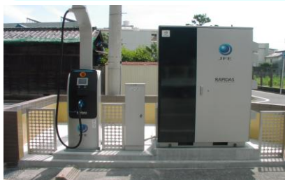
電気自動車充電設備
