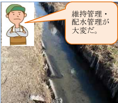
老朽化した用水路
