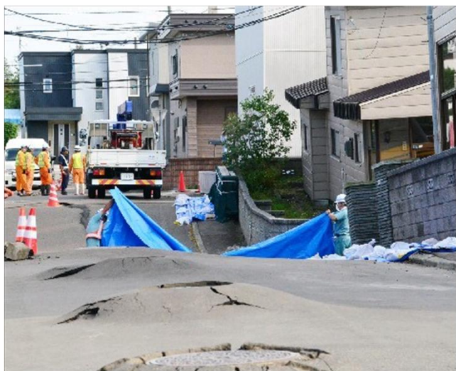
・道路の陥没
