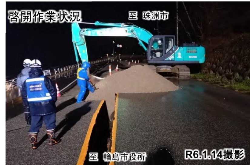
写真 道路の亀裂解消（石川県輪島市）
