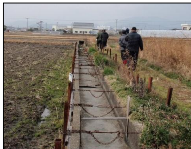
改修が進まず老朽化した用水路
