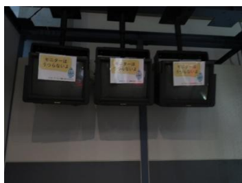
経年劣化による不具合が発生
