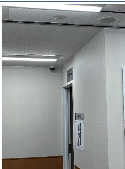
防犯カメラの設置
