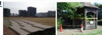
【老朽化・陳腐化した港湾緑地の例】
