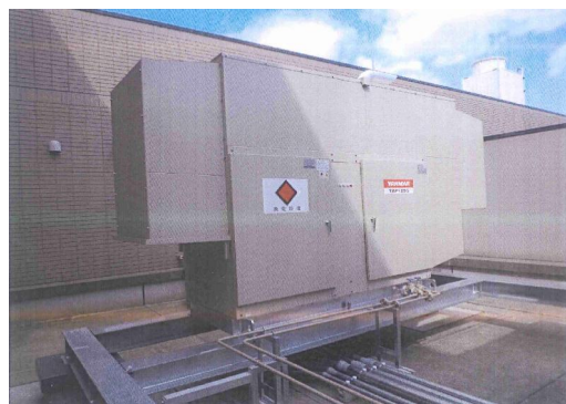
自家発電機 (125 KVA)
