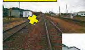
途切れた線路
