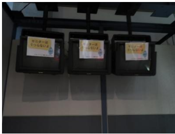
経年劣化による不具合が発生
