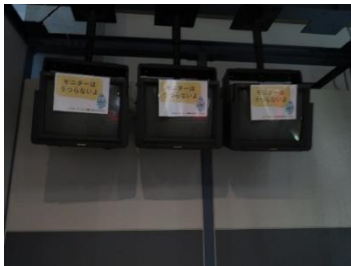
経年劣化による不具合が発生
