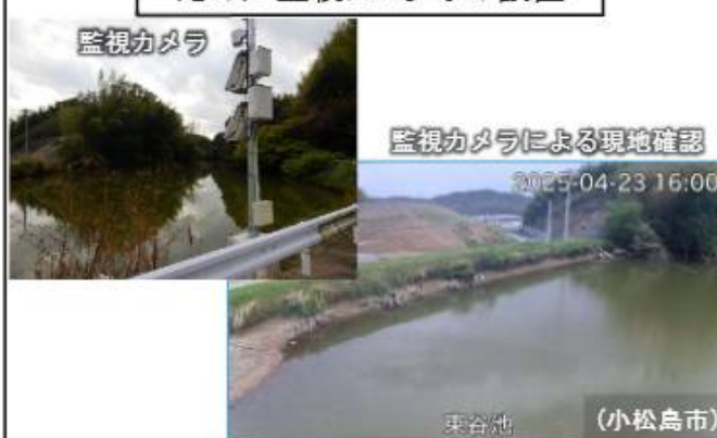
ため池監視カメラ等の設置
