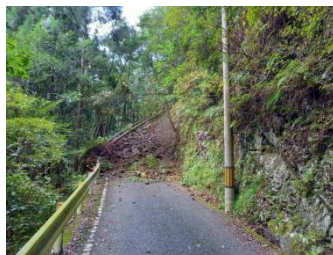
斜面崩壊による道路の通行止
