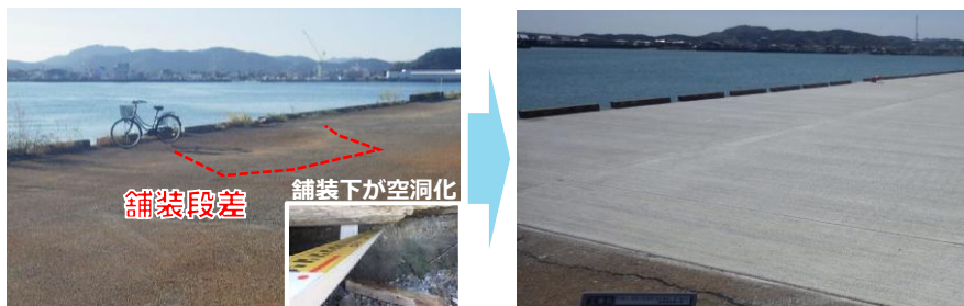
徳島小松島港(末広地区) 【物揚場の舗装補修・中詰固化処理】
