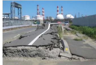
液状化による道路被災例 (2011 鹿島港)
