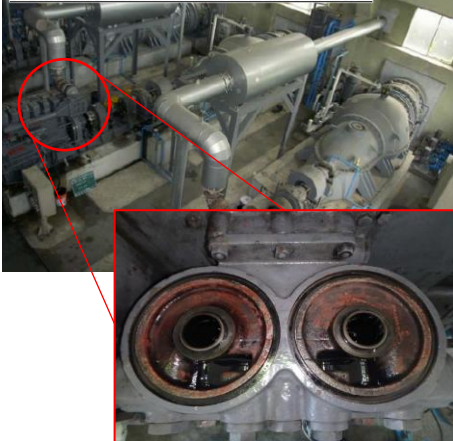
老朽施設の状況（多々羅川排水機場）
