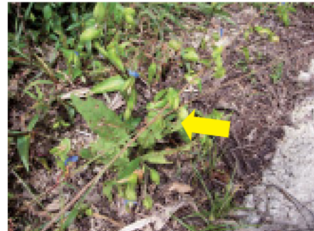
電線が草に接触している
