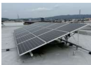
太陽光パネル設置施設
