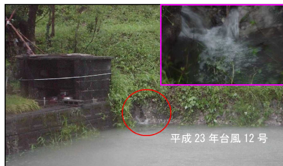
写真 2-6 海部川における堤防漏水の状況
