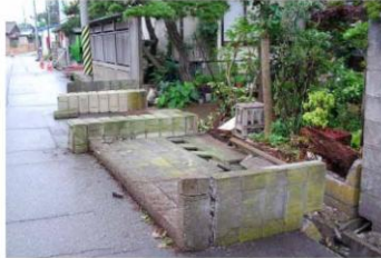
地震により、倒壊したブロック塀(平成19年新潟県中越沖地震) (写真提供：埼玉県)
