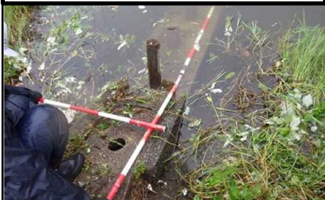
取水施設（斜樋）
