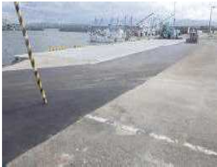
岸壁の老朽化対策 (長原漁港)
