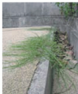
ハシピタン未施工
