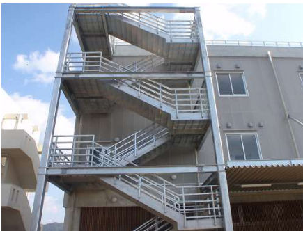
▲研究防災棟には発災時に屋上に避難するための階段が設置されています。キュービクル、自家発電装置、冷蔵庫は、発災時に稼働できるよう3階に設置されています
