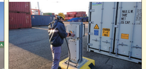
冷凍コンテナ用電源 Power supply to Reffer container
