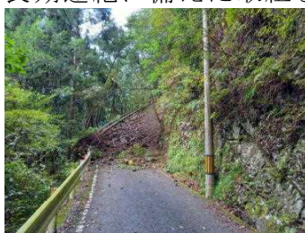
斜面崩壊による道路の通行止
