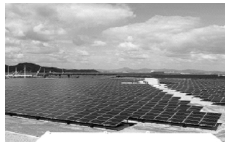
和田島太陽光発電所
