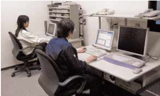
テレメータ中央監視室
