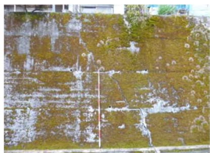
道路擁壁の亀裂
