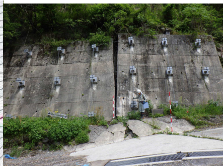
④道路擁壁の押し出し
