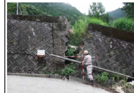
道路擁壁の開口亀裂
