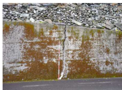
道路擁壁の亀裂
