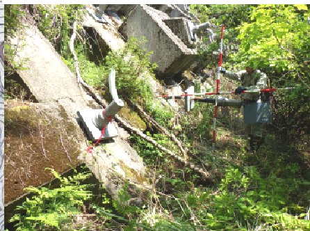
③アンカーの抜け
