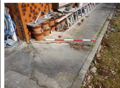
土間コンの亀裂
