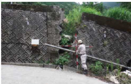
②道路擁壁の開口亀裂
